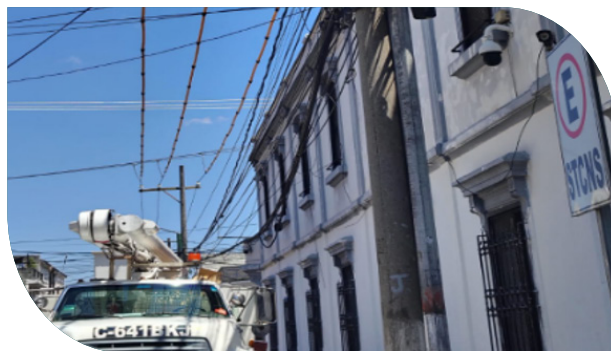
Sistema de aislamiento de las líneas eléctricas
